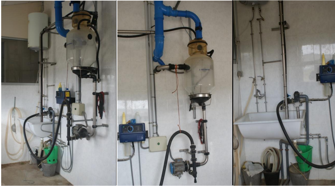
Lote nº 2: Unidad final compuesta por tuberías, pileta, lavadora y depósito.
